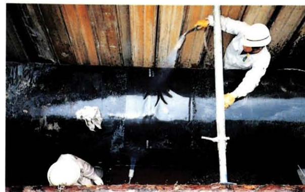
上水道送水管
