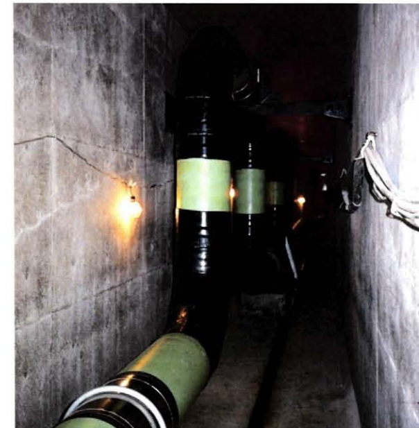
中圧ガス本管
