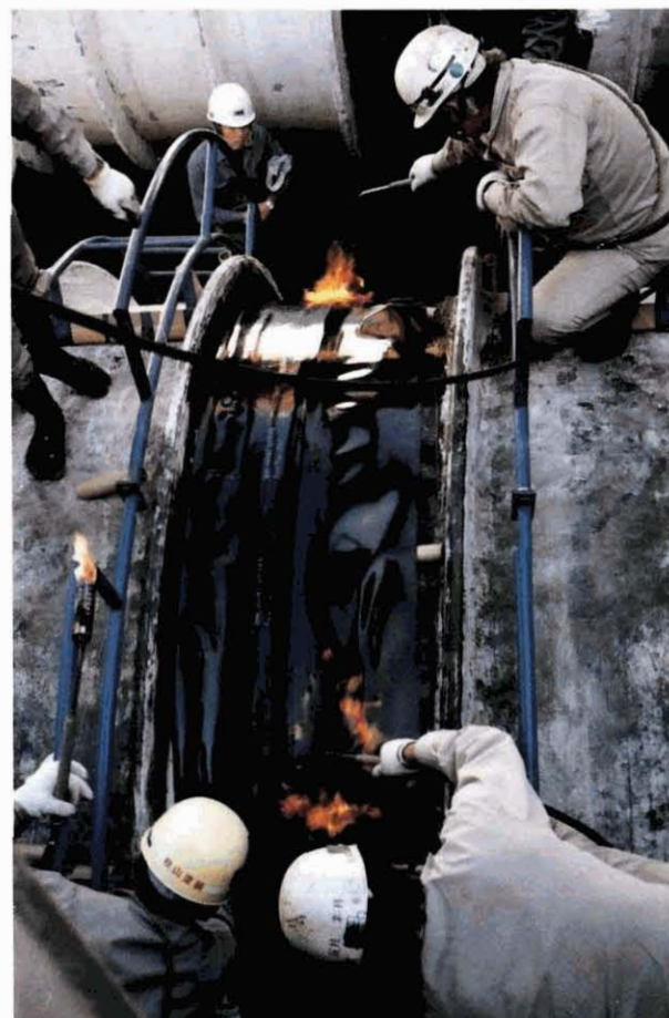
流況調整河川導水路
