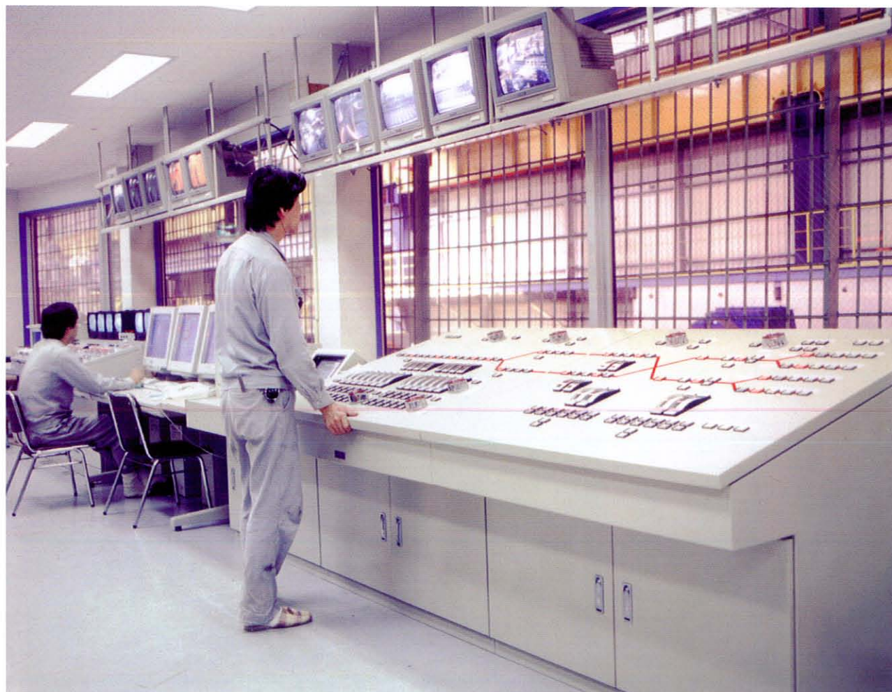
▲最新の設備で管理するオペレーションルーム
