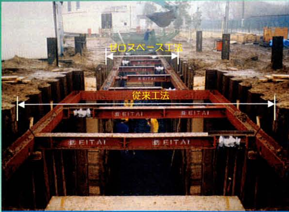
実証試験工事での現状工法と「ゼロスペース工法」の掘削幅比較
