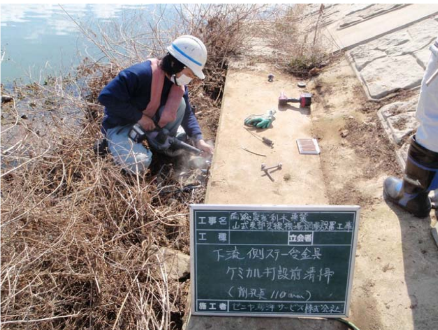
【写真タイトル】下流側 ステー金物 【写真 - 大分類】工事 【写真区分】施工状況写 真 【工種区分予備】ケミカ ルアンカー打設前清掃
