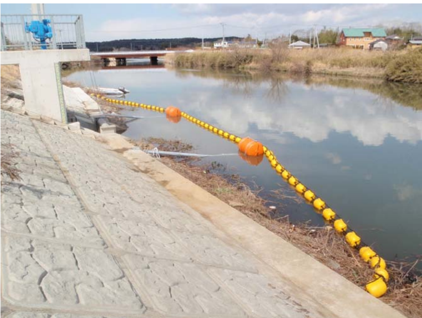
【写真タイトル】網場設置状況 【写真 - 大分類】工事 【写真区分】施工状況写真 【工種区分予備】設置完了 下流側から望む
