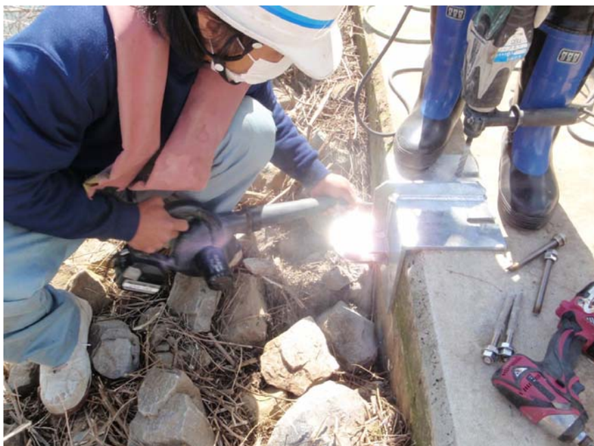
【写真タイトル】上流側 ビームヒンジ受金物 【写真 - 大分類】工事 【写真区分】施工状況写 真 【工種区分予備】ケミカ ルアンカー打設前清掃
