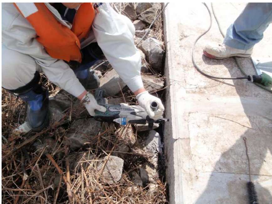
【写真タイトル】上流側 スレー金物 【写真 - 大分類】工事 【写真区分】施工状況写 真 【工種区分予備】アンカ ー削孔状況
