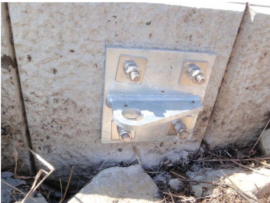
【写真タイトル】上流側 ステー金物 【写真 - 大分類】工事 【写真区分】施工状況写 真 【工種区分予備】設置完 了
