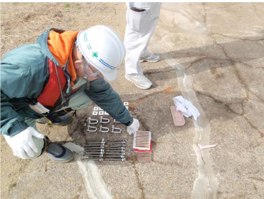
【写真タイトル】受入材料確認 【写真 - 大分類】工事 【写真区分】品質管理写真 【工種区分予備】ケミカ ルアンカー確認 M12×16セット
