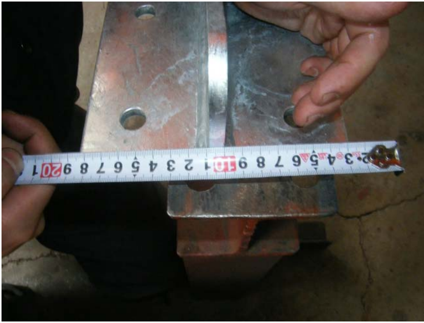
【写真タイトル】寸法検査（自主検査） 【写真 - 大分類】工事 【写真区分】施工状況写真 【工種】製作工 【種別】ビーム 【細別】護岸側ステー受け金具 【工種区分予備】ステー連結部厚み 設計値9 実測値9
