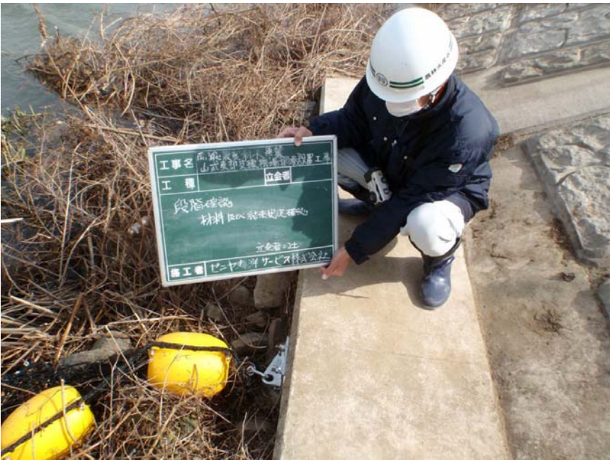
【写真タイトル】立会確認 【写真 - 大分類】工事 【写真区分】出来形管理 写真 【工種】据付工 【工種区分予備】材料及 び結束状況の確認
