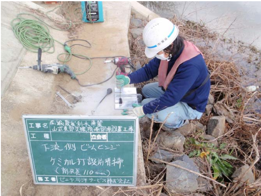
【写真タイトル】下流側 ビームヒンジ受金物 【写真 - 大分類】工事 【写真区分】施工状況写 真 【工種区分予備】ケミカ ルアンカー打設前清掃
