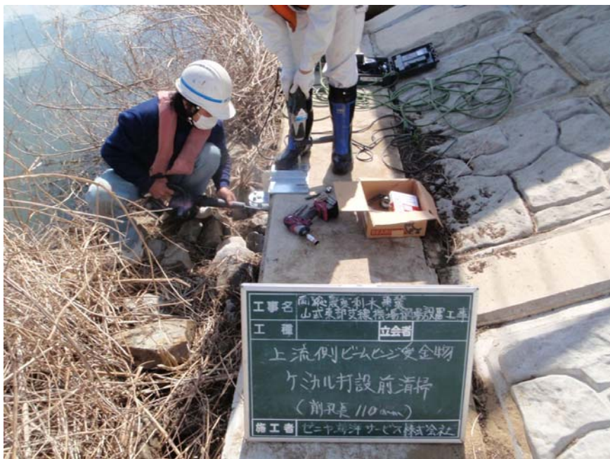
【写真タイトル】上流側 ビームヒンジ受金物 【写真 - 大分類】工事 【写真区分】施工状況写 真 【工種区分予備】ケミカ ルアンカー打設前清掃
