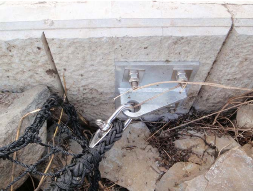
【写真タイトル】上流側 ステー設置部結束状況 【写真 - 大分類】工事 【写真区分】施工状況写 真 【工種区分予備】設置完 了
