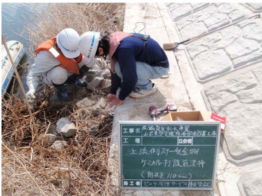
【写真タイトル】上流側 スレー金物 【写真 - 大分類】工事 【写真区分】施工状況写 真 【工種区分予備】ケミカ ルアンカー打設前清掃
