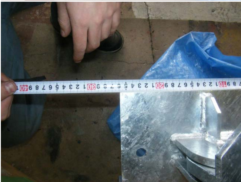
【写真タイトル】寸法検査（自主検査） 【写真 - 大分類】工事 【写真区分】施工状況写真 【工種】製作工 【種別】ビーム 【細別】護岸側ビームヒンジ受け金具 【工種区分予備】ヒンジ幅 設計値260 実測値260
