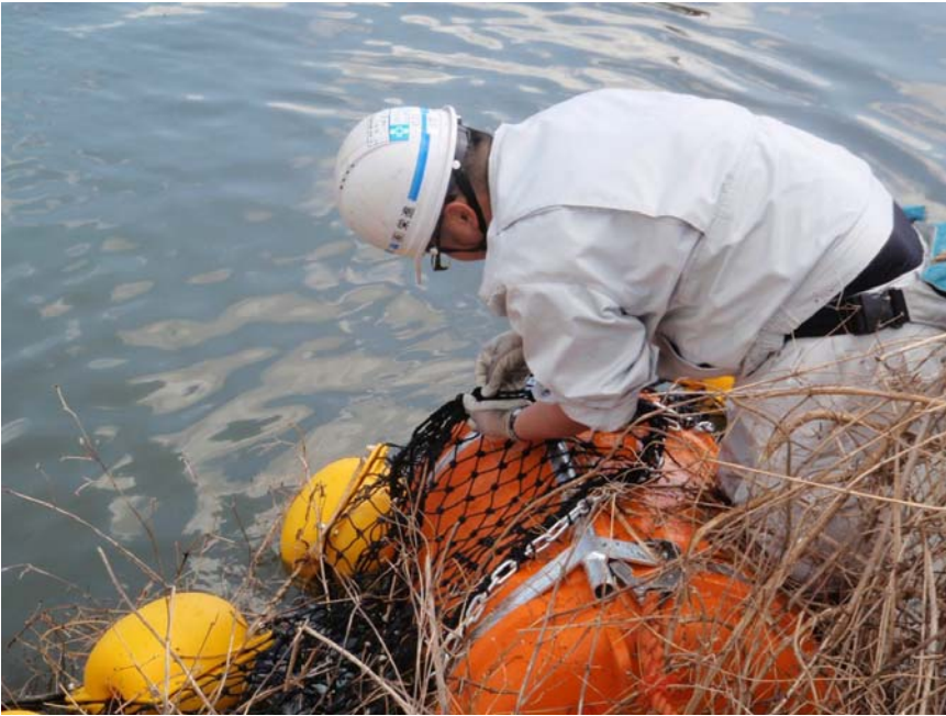
【写真タイトル】網場設置状況 【写真 - 大分類】工事 【写真区分】施工状況写真 【工種区分予備】ビーム先端網場結束状況
