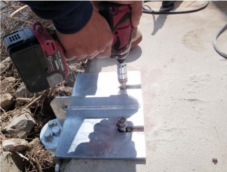
【写真タイトル】上流側 ビームヒンジ受金物 【写真 - 大分類】工事 【写真区分】施工状況写 真 【工種区分予備】アンカ ー設置状況
