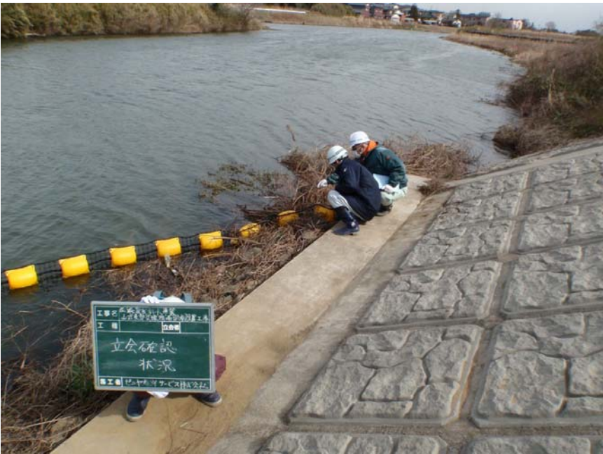
【写真タイトル】立会確認 【写真 - 大分類】工事 【写真区分】出来形管理 写真 【工種】据付工 【工種区分予備】材料及 び結束状況の確認
