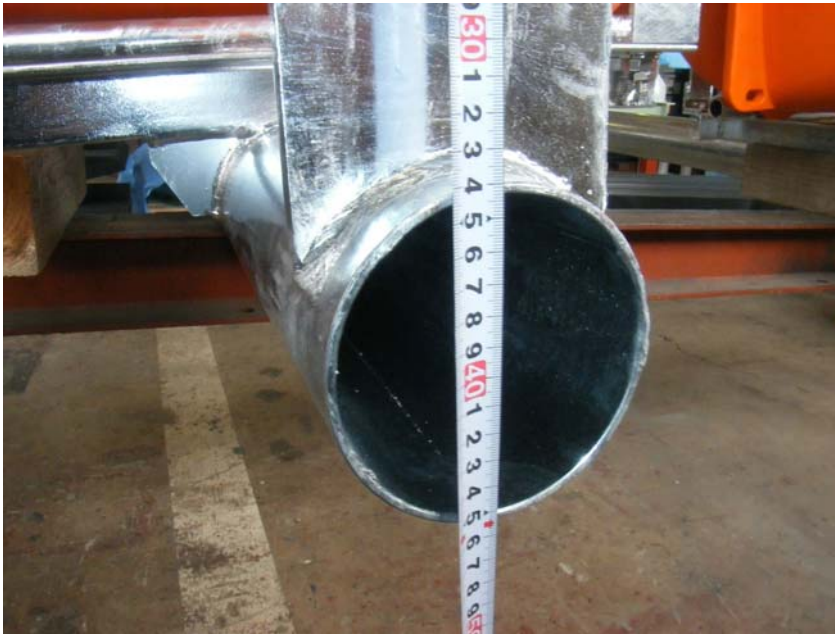
【写真タイトル】寸法検査（自主検査） 【写真 - 大分類】工事 【写真区分】施工状況写真 【工種】製作工 【種別】ビーム 【細別】下流側係留ビーム 【工種区分予備】先端高さ 設計値340 実測値340
