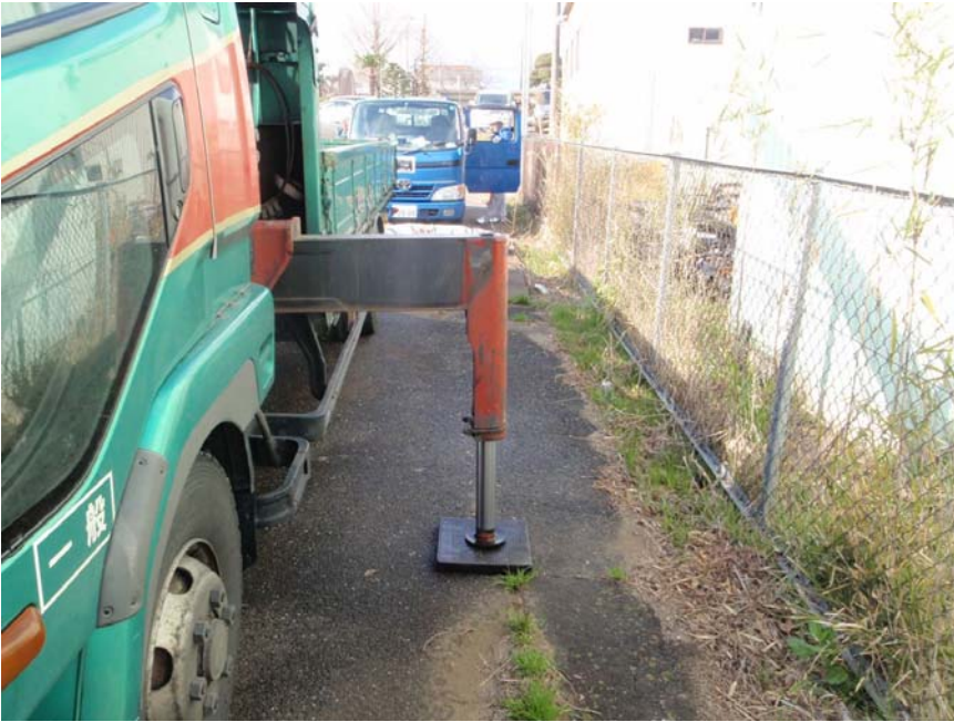
【写真タイトル】提案3： 法面崩壊、地盤陥没の対策
