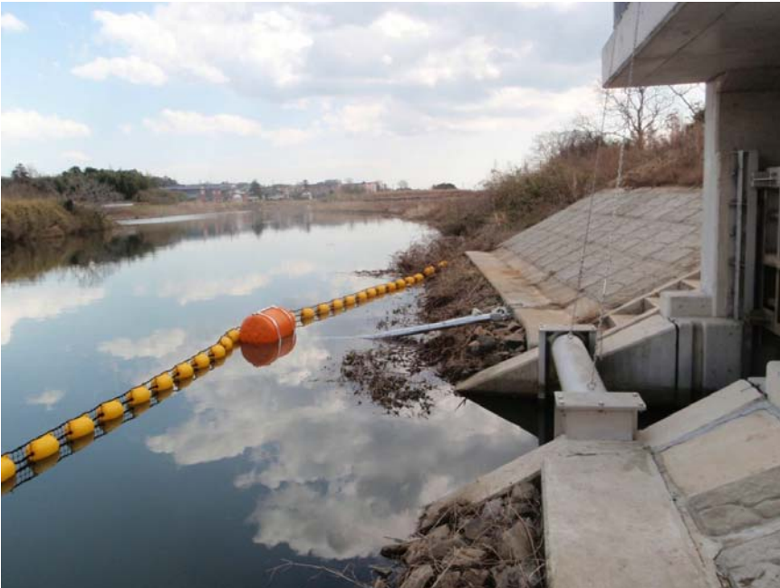
【写真タイトル】下流側 ビーム設置状況 【写真 - 大分類】工事 【写真区分】施工状況写 真 【工種区分予備】設置完 了
