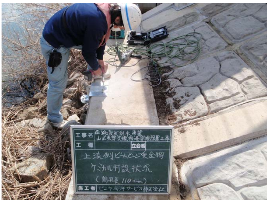
【写真タイトル】上流側 ビームヒンジ受金物 【写真 - 大分類】工事 【写真区分】施工状況写 真 【工種区分予備】アンカ 一削孔状況 削孔長110mm
