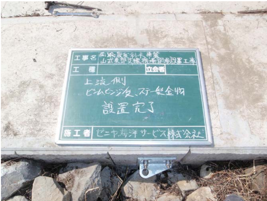
【写真タイトル】上流側 ステー金物 【写真 - 大分類】工事 【写真区分】施工状況写 真 【工種区分予備】設置完 了
