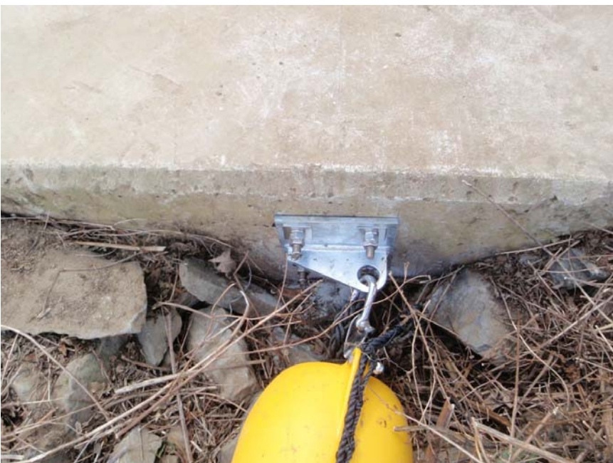
【写真タイトル】下流側 ステー設置部結束状況 【写真 - 大分類】工事 【写真区分】施工状況写 真 【工種区分予備】設置完 了
