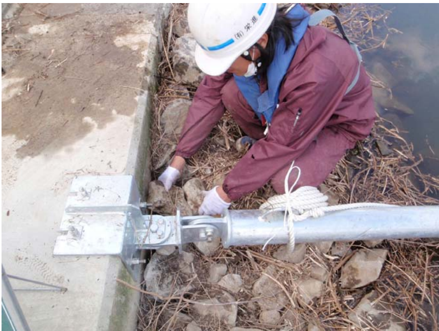
【写真タイトル】提案5： 捨石法面の保護対策 【写真 - 大分類】工事 【写真区分】施工状況写真 【工種区分予備】捨て石 隙間に詰め物をし安定させる
