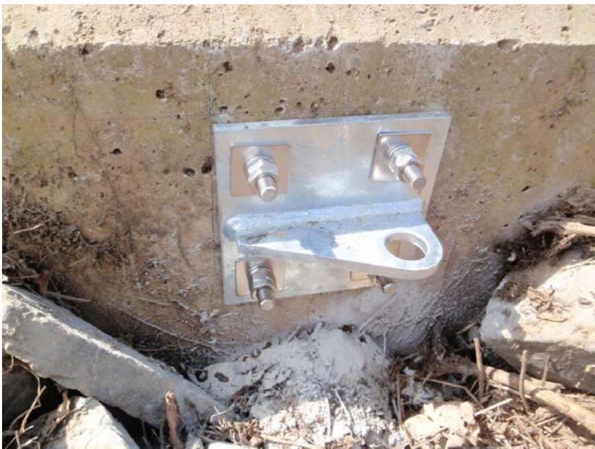
【写真タイトル】下流側 ステー金物 【写真 - 大分類】工事 【写真区分】施工状況写 真 【工種区分予備】設置完 了
