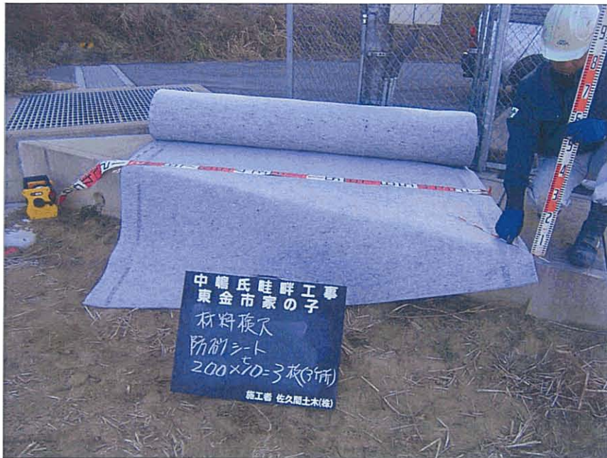
写真区分：施工状況写真 工種：柵渠吸い出し復旧工 写真タイトル：使用材料(吸出し防止シート)
