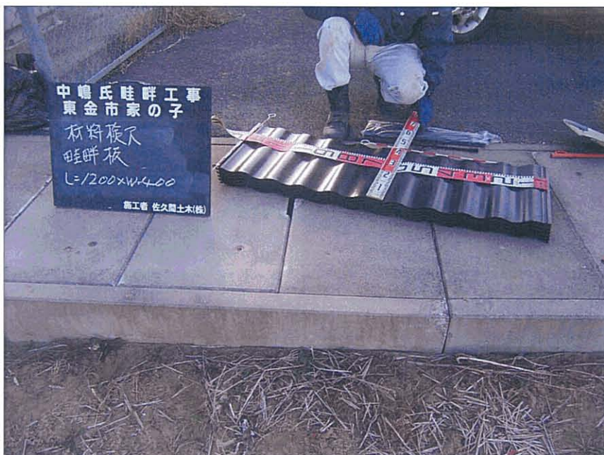
写真区分：施工状況写真 工種：波板設置工 写真タイトル：使用材料(畦畔板)
